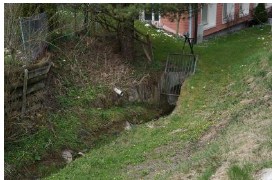
Abb. 67: Vormühlebach Abs. 1, Gitter vor Eindolung
